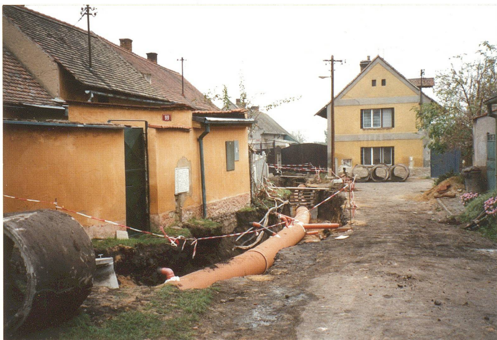
Komplikace s kanalizací 657.
